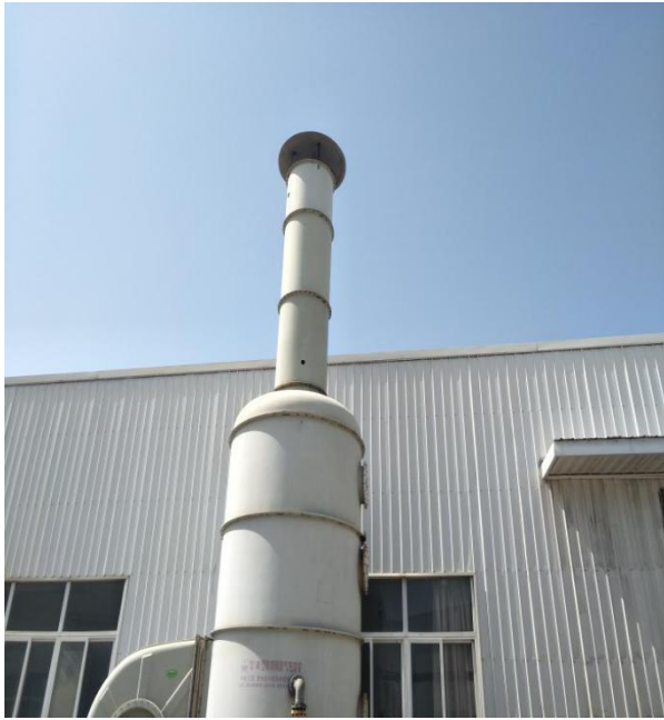
北区 B-3 危废暂存仓库废气处理设备
