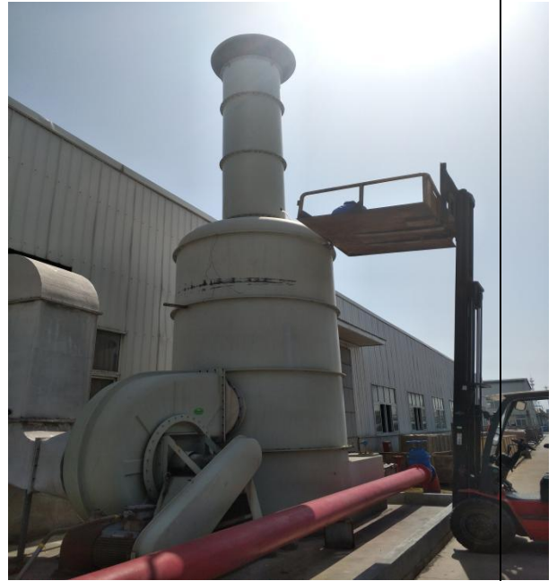
北区 B-4 危废暂存仓库废气处理设备
